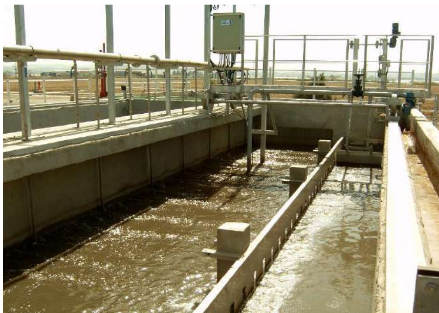
Imatge d'un dessorrador-desgreixador d'una depuradora.
