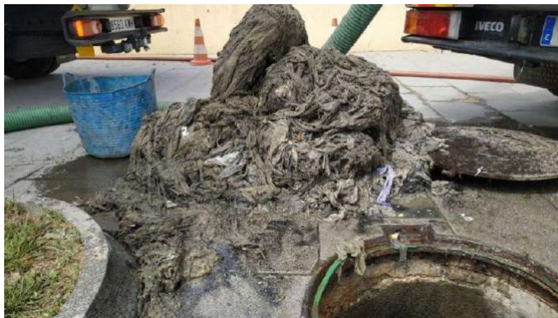
Image d'impropis (majoritàriament tovallolletes humides) extrets d'un col·lector i que poden causar grans obturacions. Font: Diario Público
