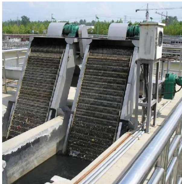
Imatge d'unes Reixes a l'entrada de la depuradora.
